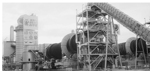
石巻ブロック災害廃棄物焼却処理施設(ロータリーキルン炉、300t/日×2基)
