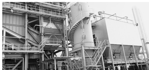
石巻ブロック災害廃棄物焼却処理施設(ストーカー炉、300t/日×3基)
