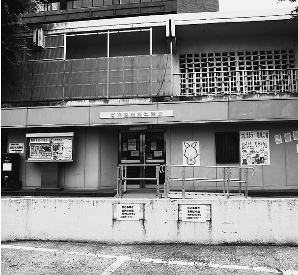
▲老朽化が進む庁舎。地盤沈下も激しく、区民の安全のためにも「清掃事業総合庁舎」の建設が急務だ
